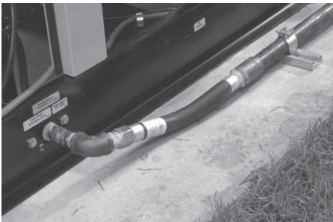
Figura 1.8 - Tubería de combustible flexible
