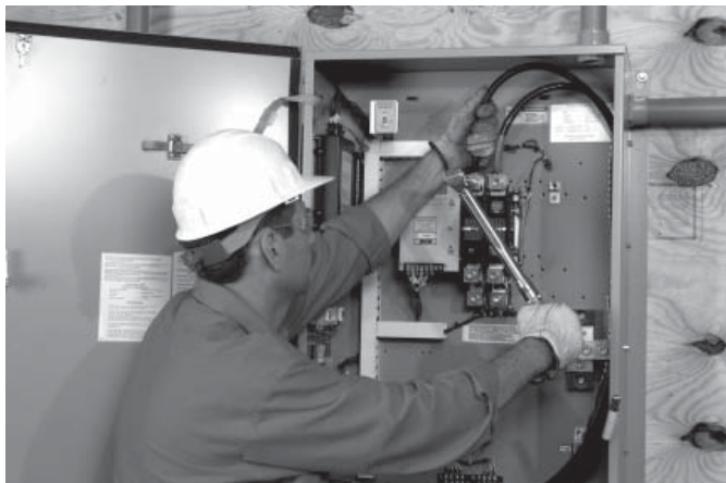
Figure 3.5 - Apriete de terminales
